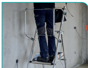
Protection de l'opérateur par garde-corps et chaînettes.
