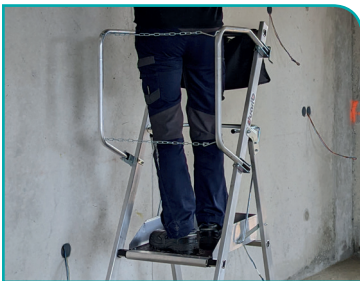
Protection de l'opérateur par garde-corps et chaînettes.
